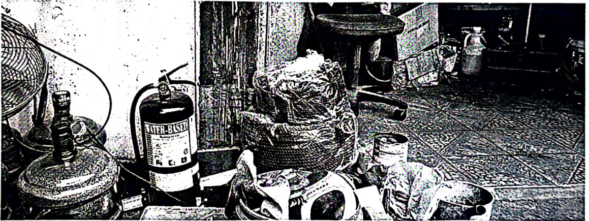
照片之滅火筒（9公升水劑）設於貨物儲存庫旁當眼處（<m）
